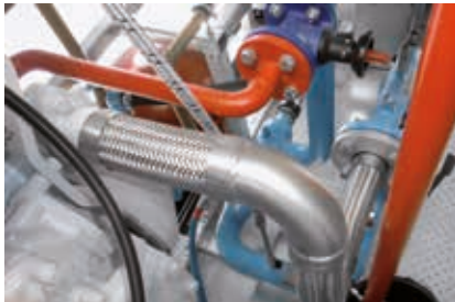
Edelstahlwellschlauch in einem Blockheizkraftwerk mit 90°-Bogen und Losflanschen
